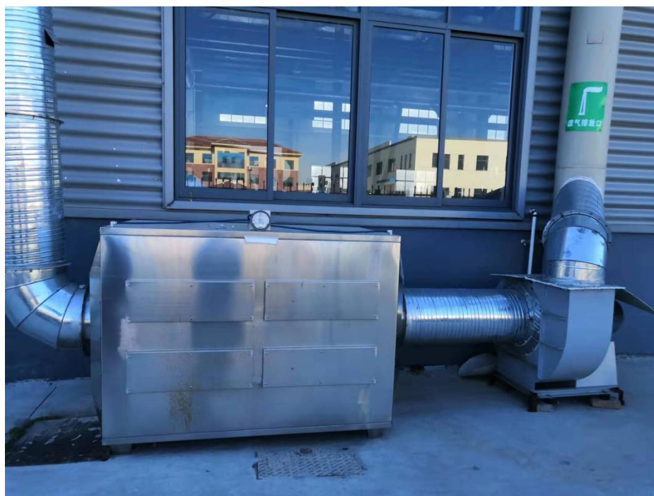
废气设备图片
