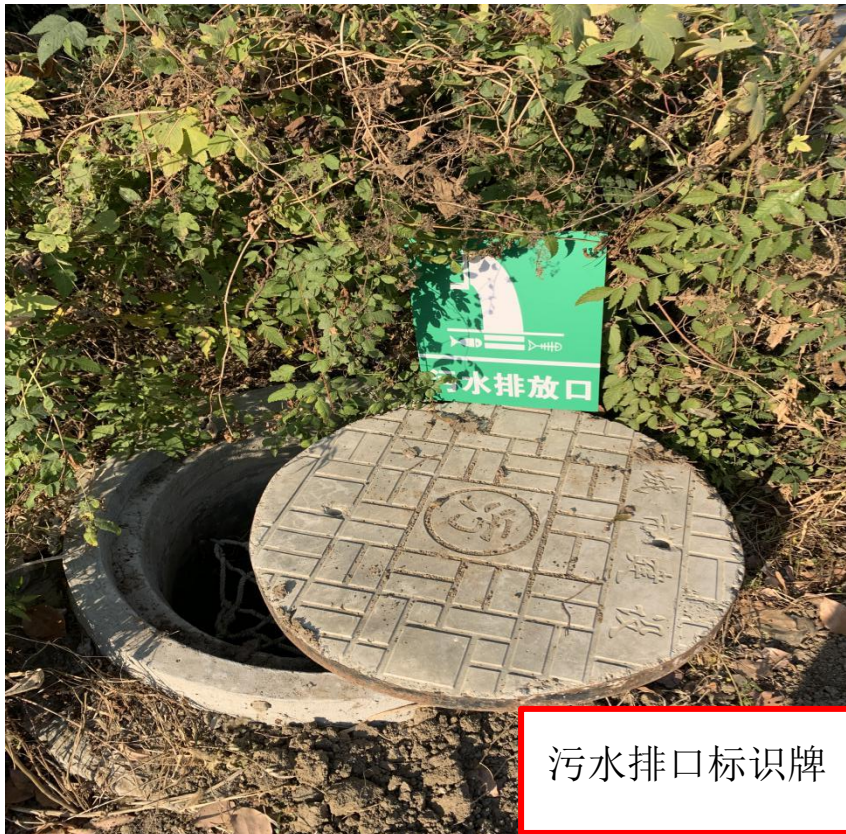
污水排口标识牌
