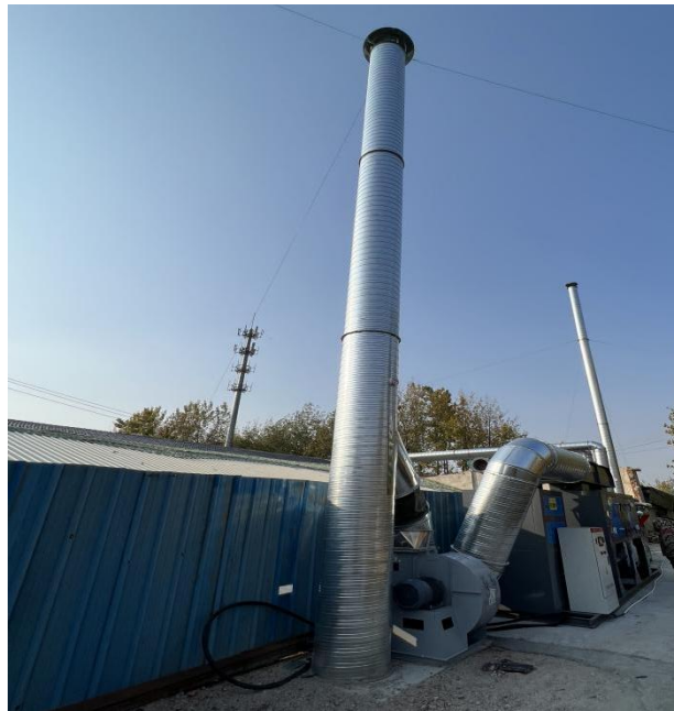
图 2-4 废气处理设施及 15 米高排气筒
