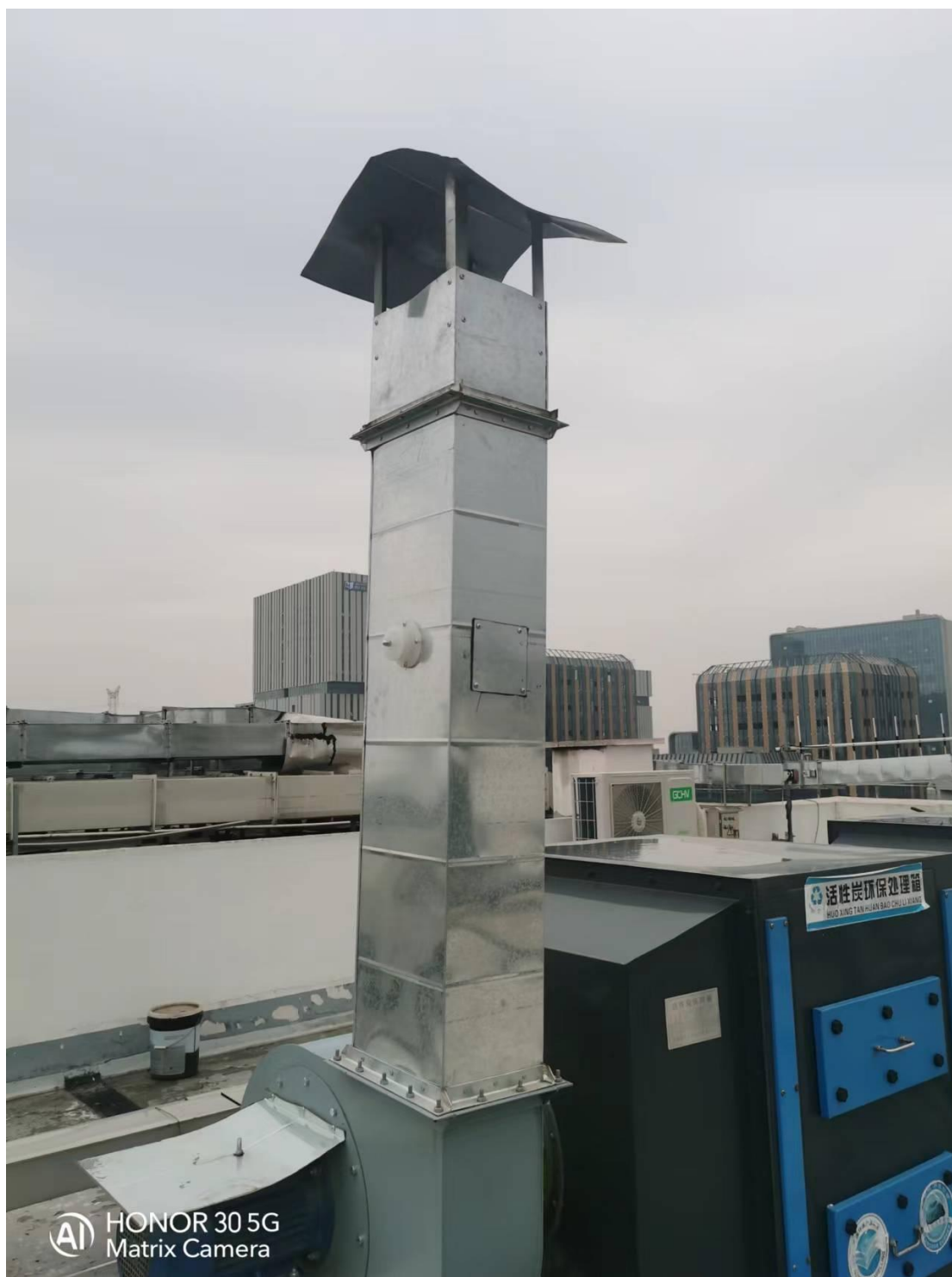
废气处理设施及 25 米高 2#排气筒
