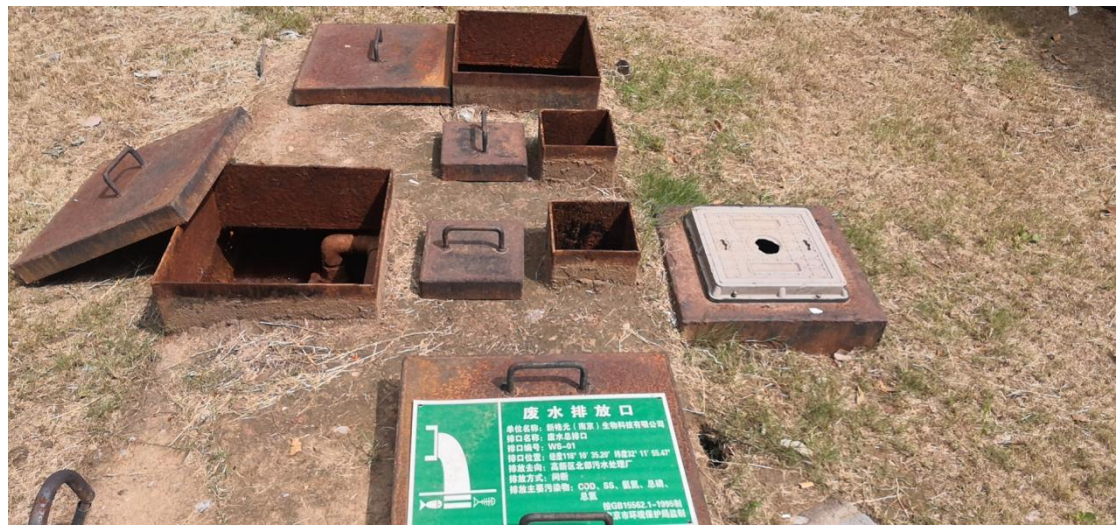
厂内污水处理站
